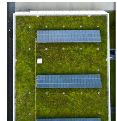
Integrale groene daken en zonnepanelen
