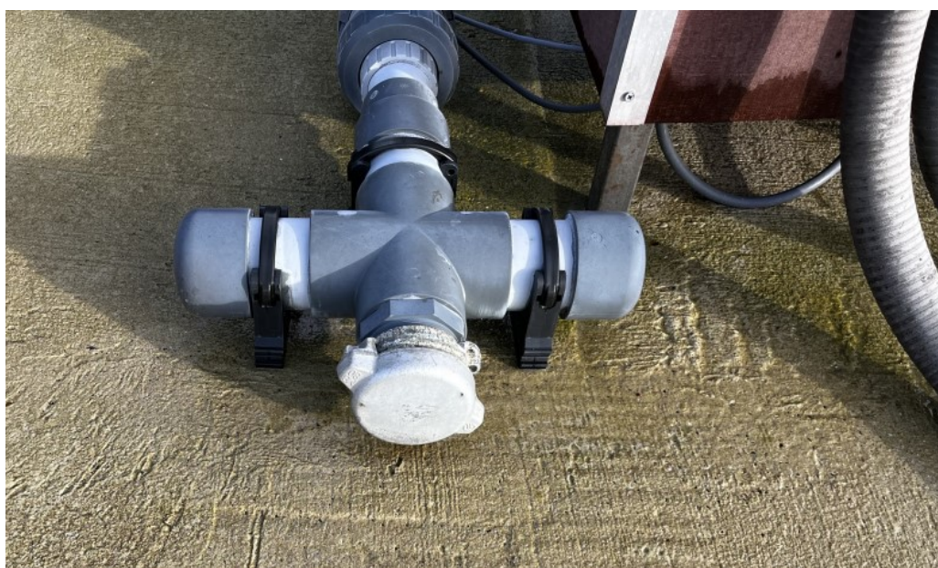
Foto van de aansluiting van de opslaginstallatie
