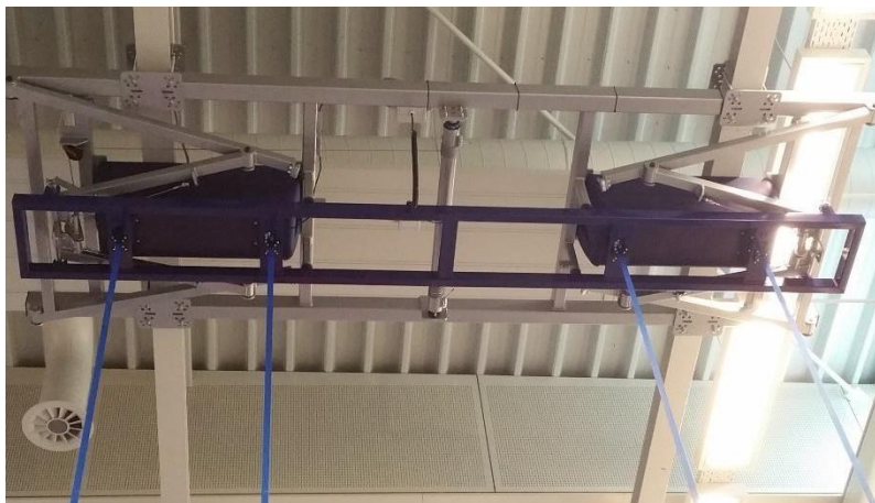
Plafondunits in verlagingsconstructie
