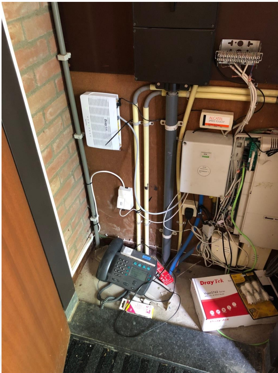
ISRA aansluitpunt industrieel verplaatst telefoontoestel.
