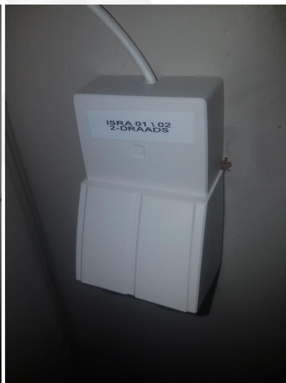
Isra koppeling meterkast kant
