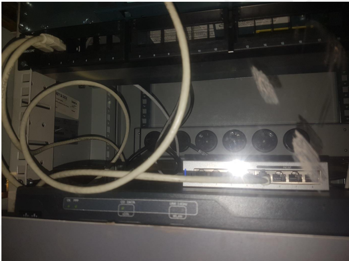
Patchkast onder bureau
