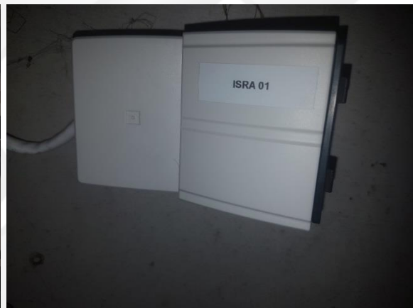
Isra koppeling meterkast kant
