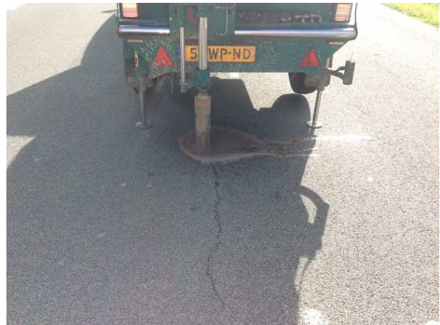
Afbeelding 2: Constructieboring ter plaatse van de scheurvorming
