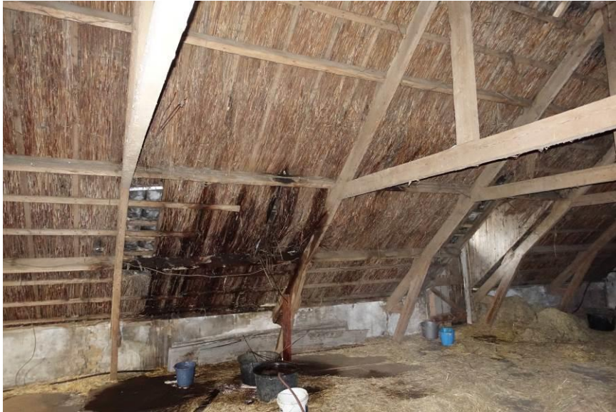
Deels beschadigde dakconstructie door lekkages.
