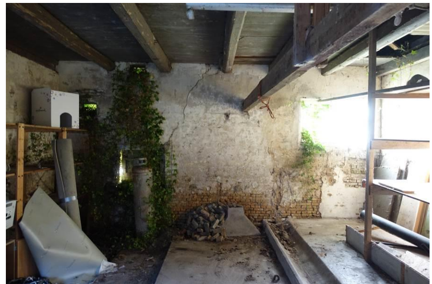
Vochtschade aan muurwerk en sterk door houtworm verzwakte vloerdelen.
