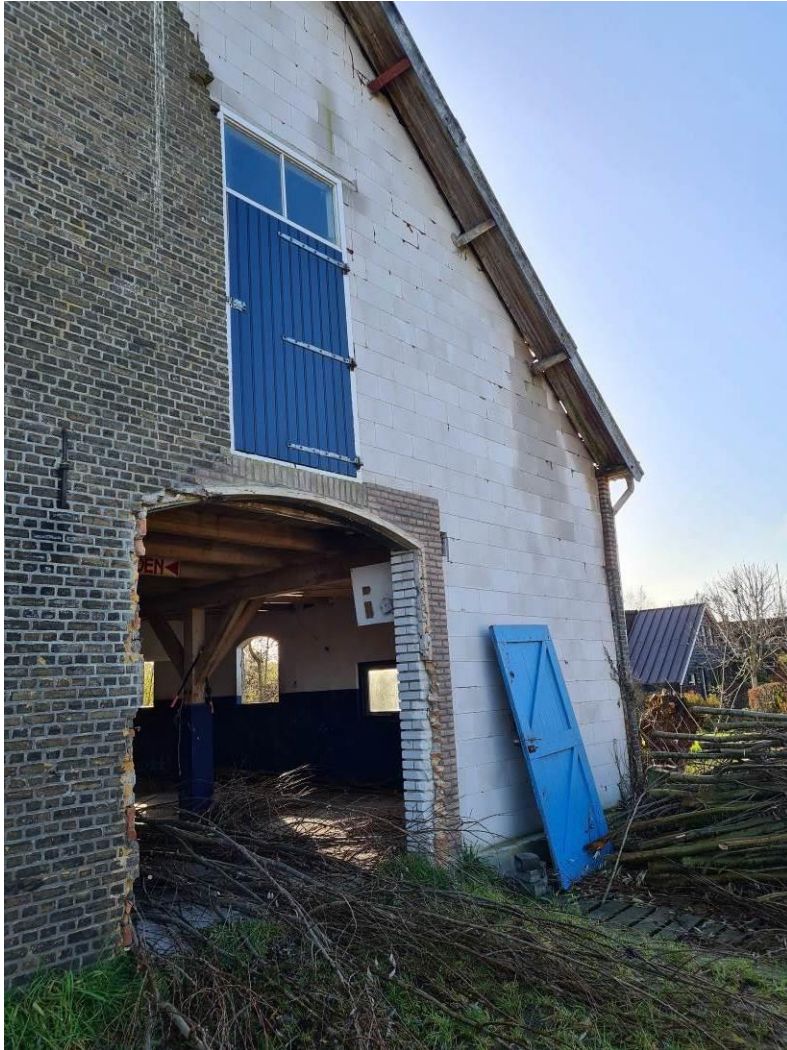
Van de achtergevel ontbreekt een deel van het metselwerk.
