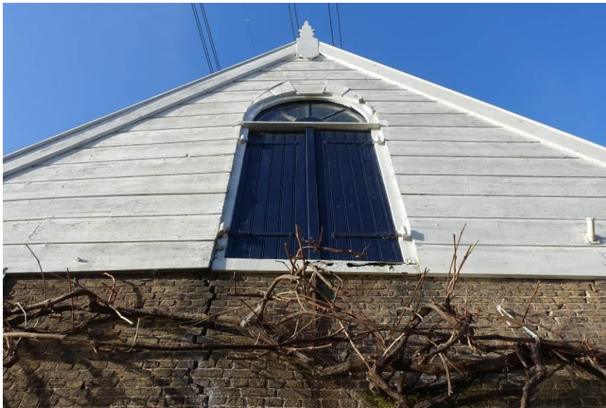
Scheuren in muurwerk en schade aan historische houten topgevel.
