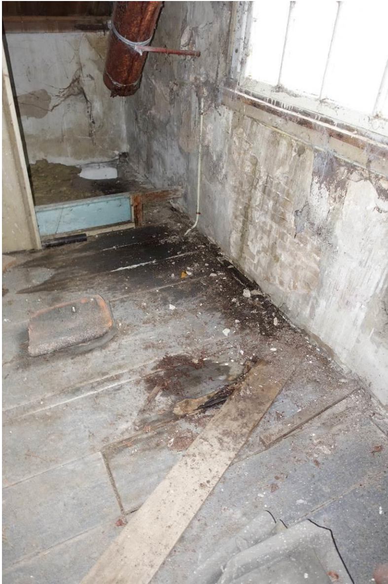
Door lekkages is schade aan constructies ontstaan.
