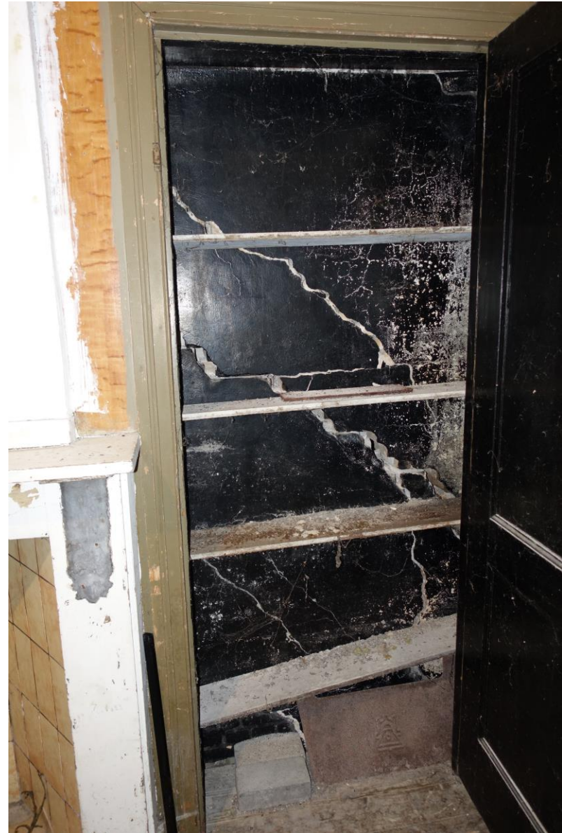
Ernstige scheurvorming in de binnenmuur.
