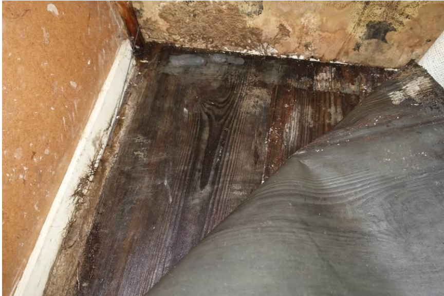
Schade aan constructies door lekkages ter plaatse van kilgoten.
