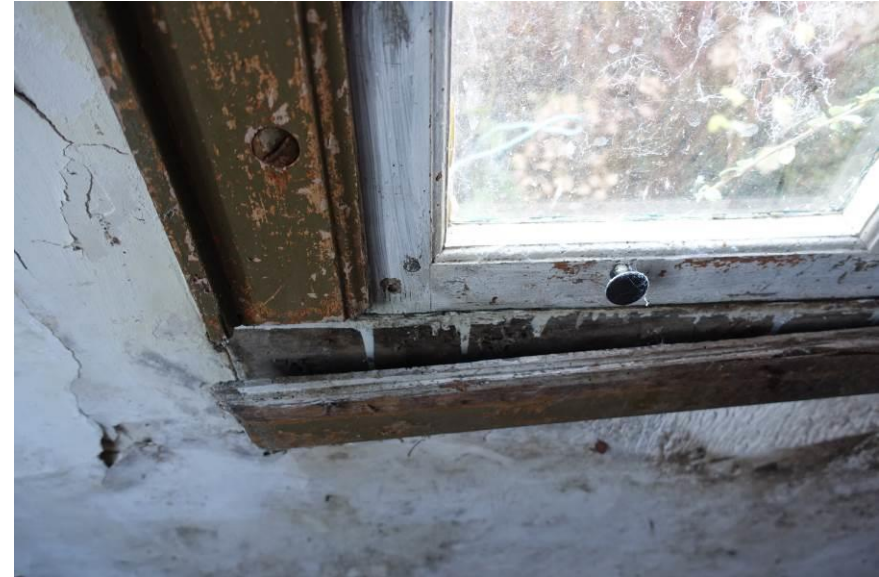
Deels weggefallen of beschadigde betimmeringen.
