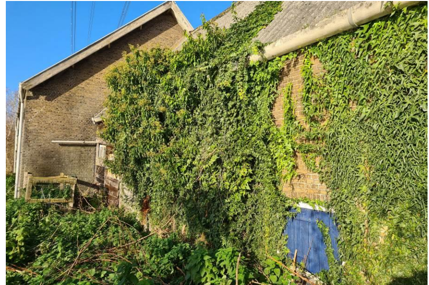
Door begroeiing is de gevel niet meer zichtbaar. Luiken zijn beschadigd.
