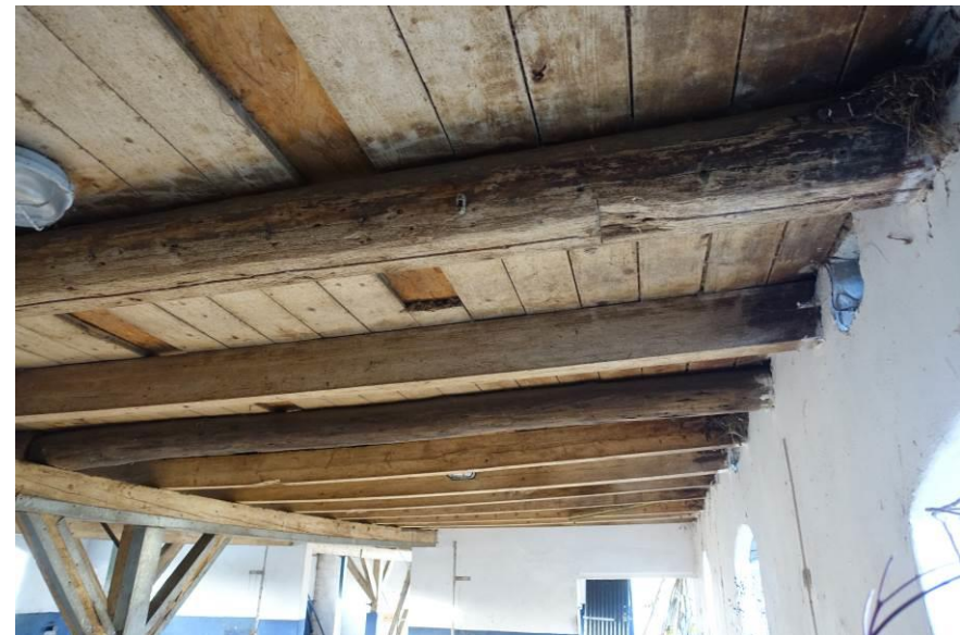
Door lekkages en houtworm aangetaste balken en vloerdelen.
