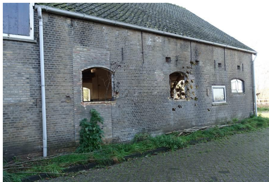
Scheurvorming en minder fraai herstelde voegen. Vensters zijn verwijderd, waarbij dagkanten ernstig beschadigd raakten.
