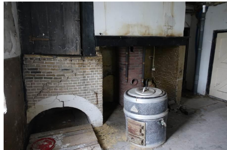
Ook de schouwen en broodoven hebben schade door zettingen.
