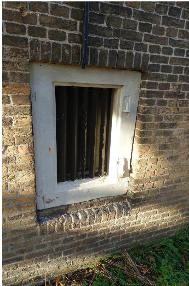
Uitgesleten voegwerk en schade aan onderdorpel kozijn.
