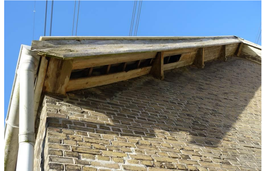
Beschadigd overstek en windveer.
