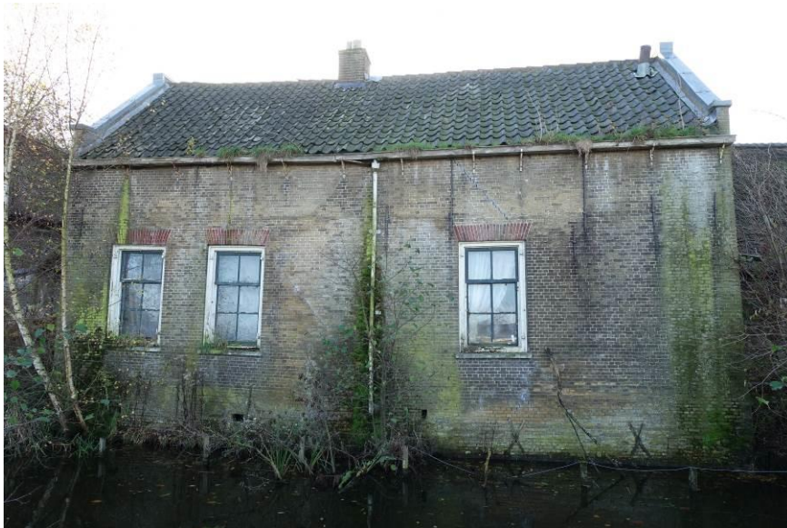
Verspreid over de gevels komt scheurvorming voor. Voegen zijn uitgesleten.
