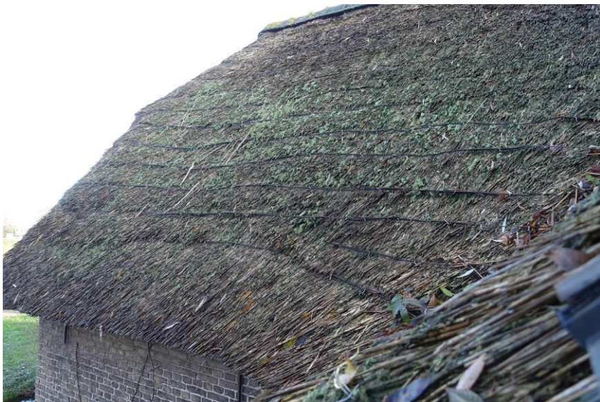
Ver teruggesleten rietdekking, waardoor lekkages ontstaan.
