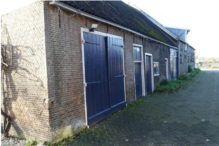
Door zettingen zijn gevelopeningen wat vervormd en is muurwerk deels wat ontzet.
