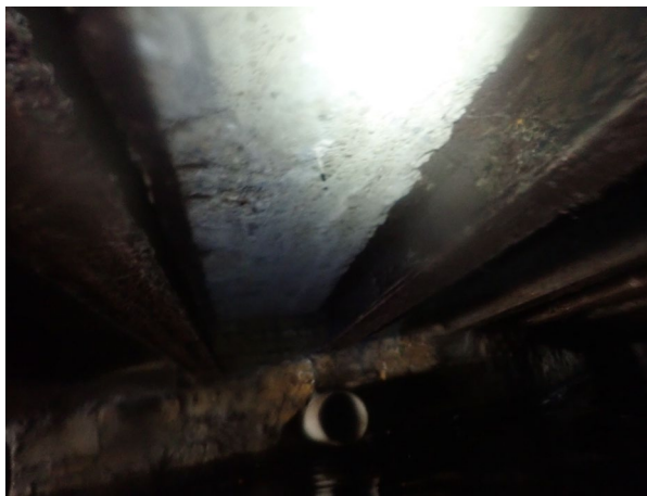
Foto 07: Oppervlaktecorrosie stalen liggers
