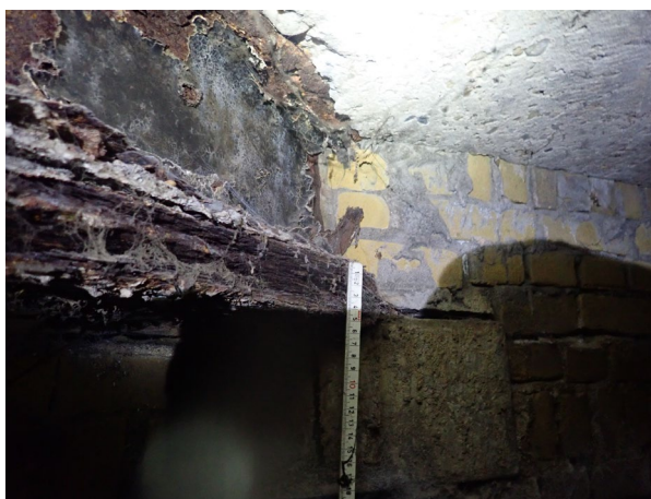
Foto 09: Sterke delaminatie onderflens
