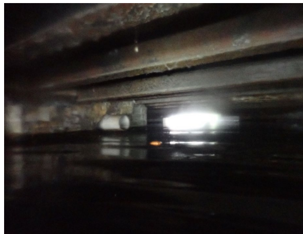
Foto 06: Gecorrodeerde stalen liggers
