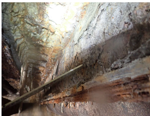
Foto 10: Corrosie liggers en deel betonschade onderzijde dek (oorspronkelijk deel)
