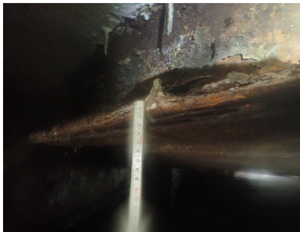
Foto 08: Corrosie en materiaalafname flenzen
