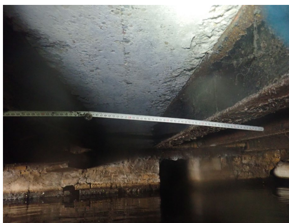
Foto 12: Opening in landhoofd (overstort?)
