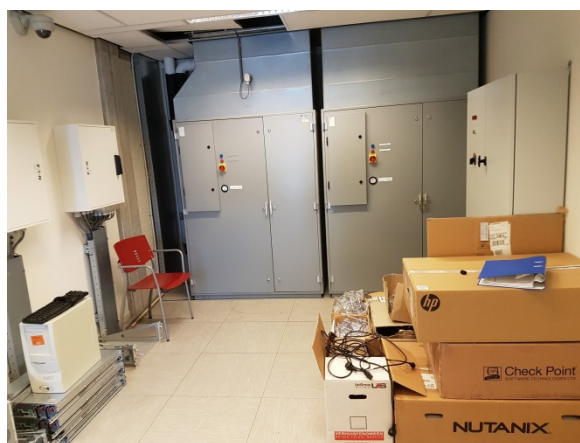
Opslag in MER ruimte
