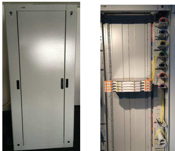
Figuur 2: Commscope GR3 ODF rack
