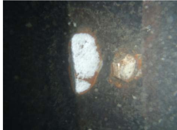
Figuur 5.6: Corrosie bouten
