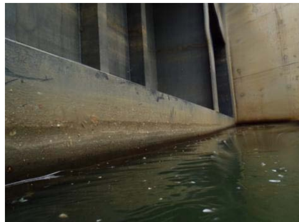
Figuur 5.8: Geen mechanische schades rond de waterlijn
