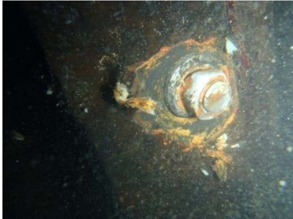
Figuur 5.5: Corrosie bouten
