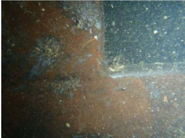
Figuur 5.9: Uniforme corrosie onderdelen deur
