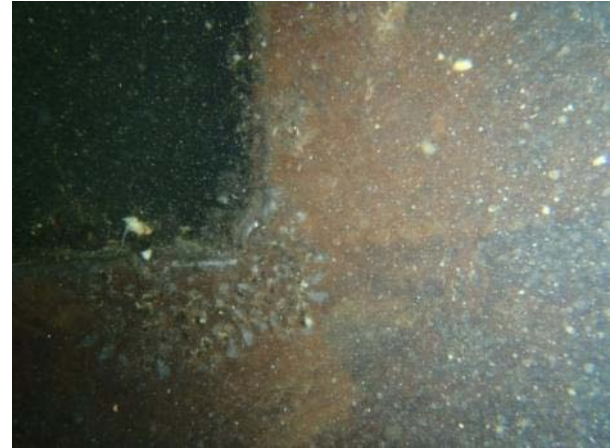
Figuur 5.10: Uniforme corrosie onderdelen deur
