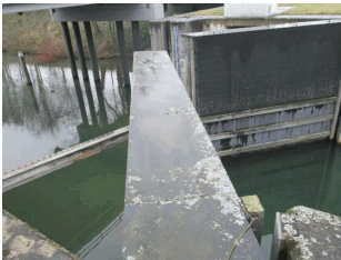
Leuning is niet aanwezig.
