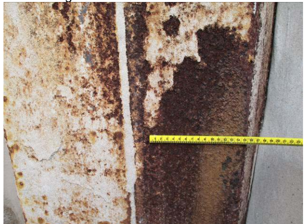
Figuur 4.11: Uniforme oppervlaktecorrosie achterzijde damwandplanken
