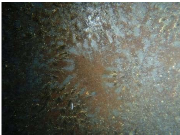
Figuur 5.7: Uniforme corrosie onderdelen deur
