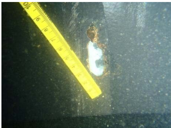
Figuur 5.13: Lokaal onthechting conservering
