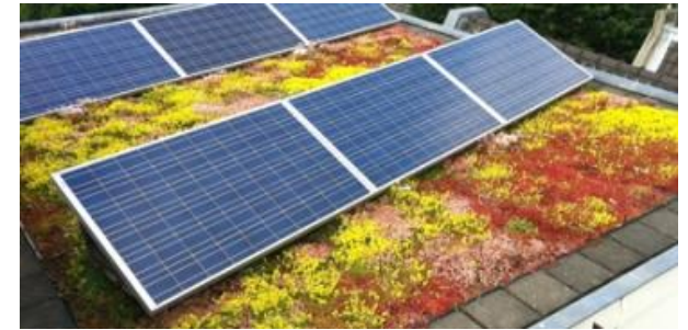
Zonnepanelen en groene daken
