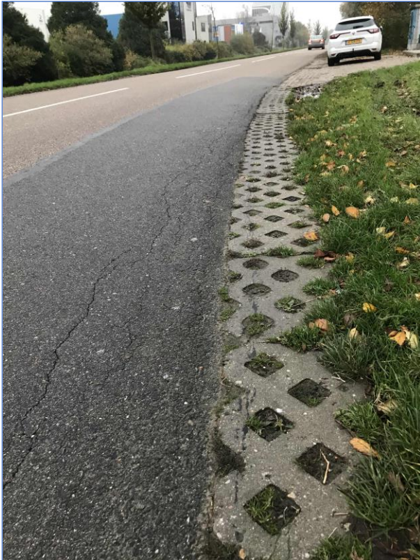
Figuur 7 Spanjaardsdam randschade
