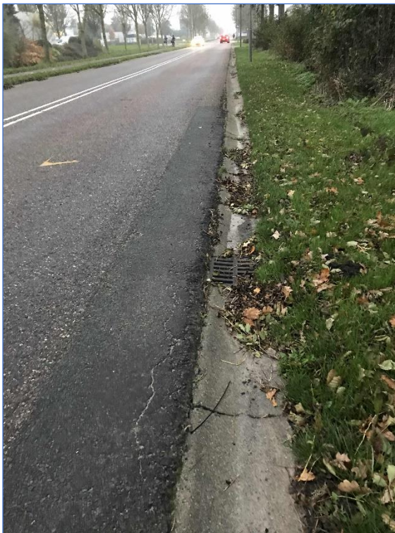
Figuur 5 De Punt randschade en verzakte goot
