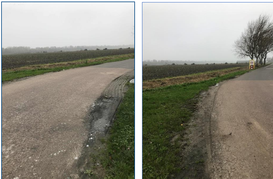
Figuur 3 Bermschade aansluiting Veertweg.
