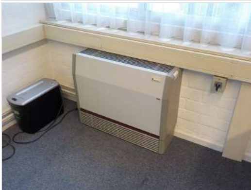
De elektrische gevelkachels zijn onverdacht
