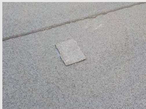
De monsternamelocaties zijn afgedekt met bitumen en dakleer
