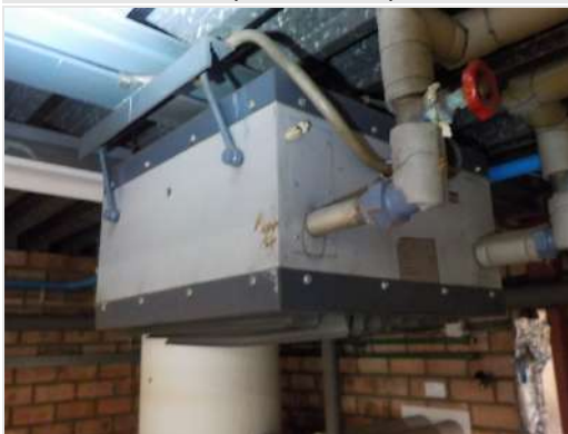
Onverdachte luchtverhitters aanwezig in gebouw 1
