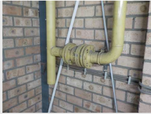
Asbestpakkingen in de gasleiding (in trappenhuis naar cv-ruimte)
