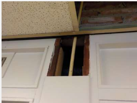
Weggebroken gevelafdekking, geen bronnen
