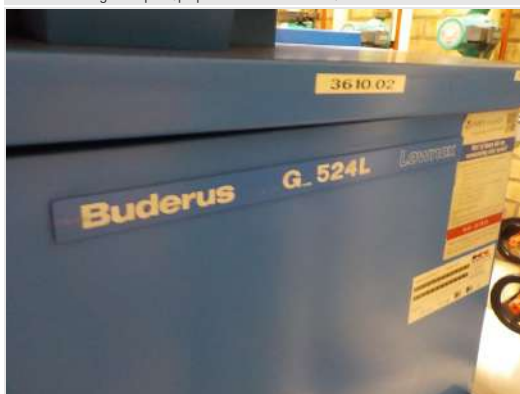
De cv-ketel is onverdacht
