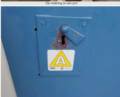
De traforuimte bevat asbestonderdelen
