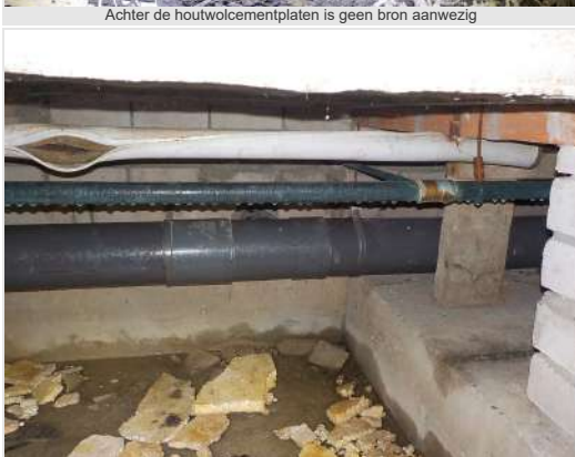
Riolering in kruipruimte: pvc
