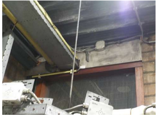
Zijde cv-ruimte, met asbestplaat op een houtplaat gemonteerd
