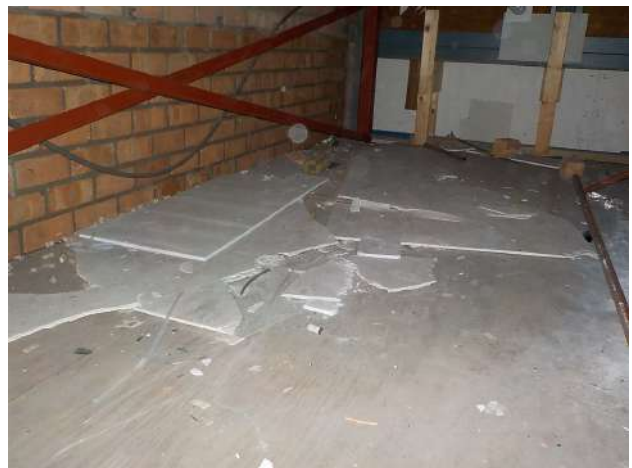
Resten beplating op de vloer in het loopgedeelte naast het magazijn
