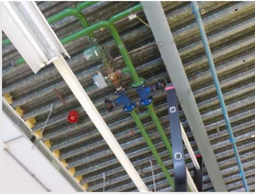
Asbesthoudende pakkingen bij de cv-leidingen (groen)
