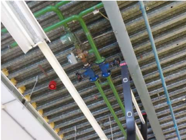
Asbesthoudende pakkingen bij de cv-leidingen (groen)
