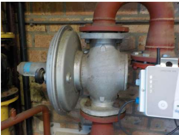
2 asbestpakkingen in de gasdrukkelep
