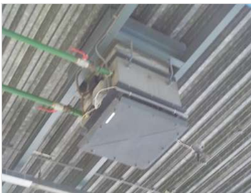
De luchtverhitters zijn nader bekeken en zijn onverdacht
