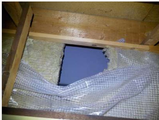
Holle ruimte gevels, geen bronnen
