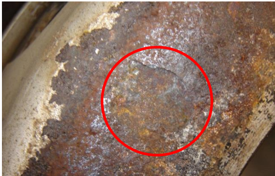
Afb 1: Te grote oneffenheid door corrosie
