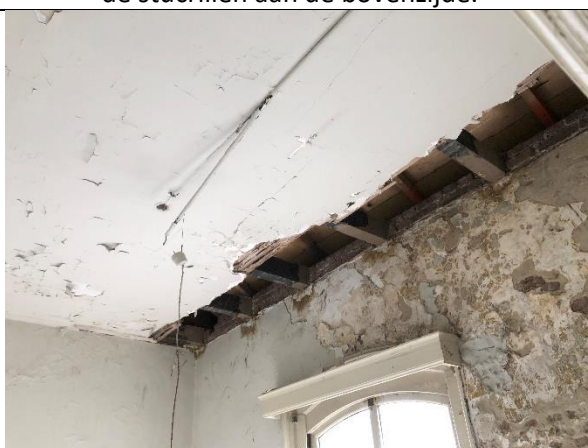
50. Opslagruimte. Pastorie ruimte. Deformatie van het geornamenteerde plafondafwerking door lekkage. De rinkellatten zijn sterk vermolmd door langdurige vochtinwerking. Het stucwerk komt los van de rinkellatten door deformatie van de stucrillen aan de bovenzijde.
