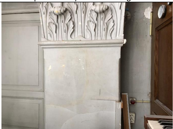
20. Ook de pilaren aan de zijden van het orgel vertonen veel scheurvorming en holklinkend stucwerk.
