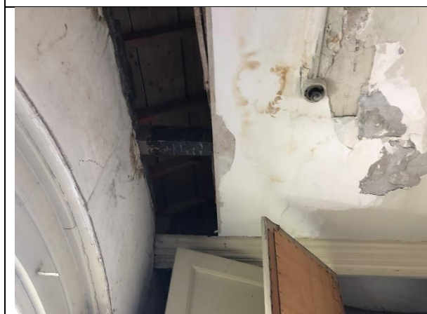
49. Pastorie ruimte. Deformatie van het geornamenteerde plafondafwerking door lekkage. De rinkellatten zijn sterk vermolmd door langdurige vochtinwerking. Het stucwerk komt los van de rinkellatten door deformatie van de stucrillen aan de bovenzijde.
