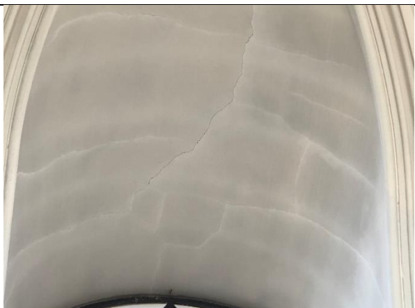
18. Op de plafondgedeelten waar aan de bovenzijde van de pleisterdraagconstructie de stucrillen door vochtinwerking gedeformeerd zijn is aan de onderzijde wat grovere (wijder openstaande) scheurvorming zichtbaar.
