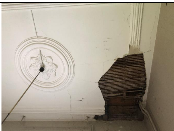
48. Pastorie ruimte. Deformatie van het geornamenteerde plafondafwerking door lekkage. De rinkellatten zijn sterk vermolmd door langdurige vochtinwerking. Het stucwerk komt los van de rinkellatten door deformatie van de stucrillen aan de bovenzijde.
