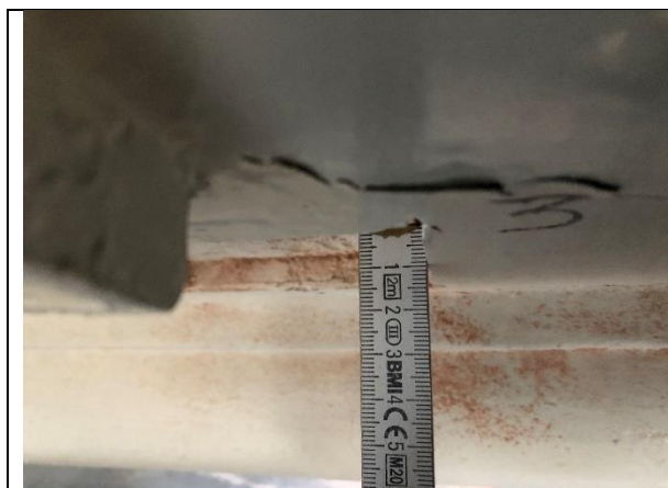
47. Onthechting stucmortel vanaf het oppervlak van de vertinlaag. De achterzijde van de losgeraakte stucmortel geeft sterk wit af (krijtend). Dikte stucmortel is \pm 5 mm.
