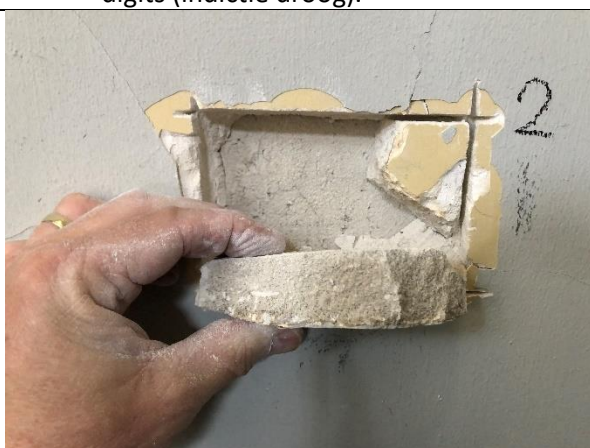
42. Onthechting stucmortel vanaf het oppervlak van de vertinlaag. De achterzijde van de losgeraakte stucmortel geeft sterk wit af (krijtend). Dikte stucmortel is 20 tot 30 mm.
