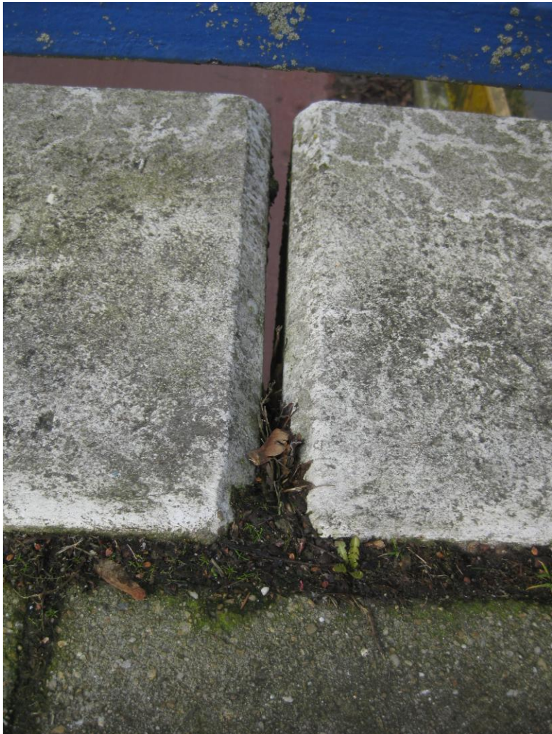
Open voeg geeft lekwater vervuiling
