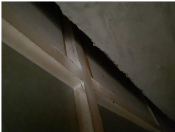
FB06: De aangetroffen gevelbeplating is in 2011 al bemonsterd en beschreven in het asbestinventarisatierapport van "Oesterbaai" met kenmerk: PAV-21094 en asbestvrij gebleken.
