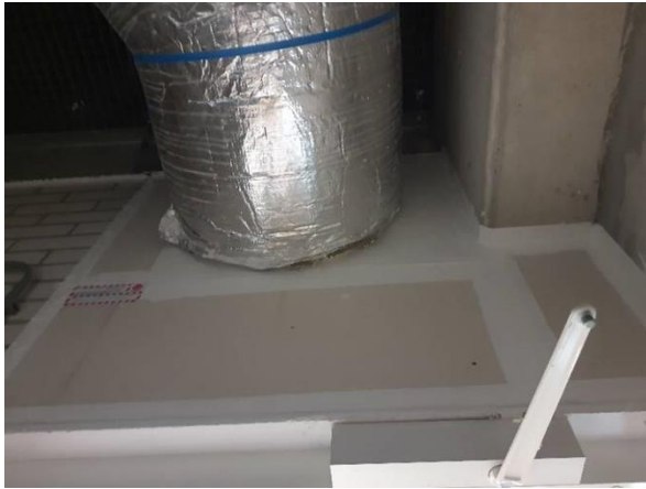
FB04: De aangetroffen brandwerende beplating is in 2011 al bemonsterd en beschreven in het asbestinventarisatierapport van "Oesterbaai" met kenmerk: PAV-21094 en asbestvrij gebleken.
