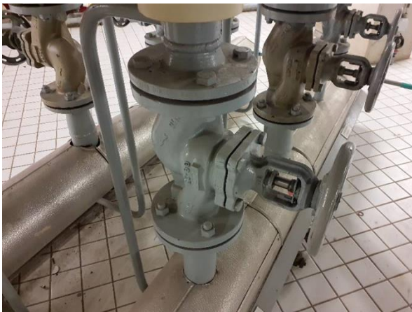
FB09: De afsluiters zijn niet inwendig onderzocht. Mogelijk zijn hier asbesthoudende stopbuspakkingen in aanwezig.
