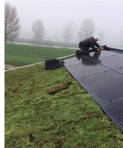
zonnepanelen op schuin groendak
