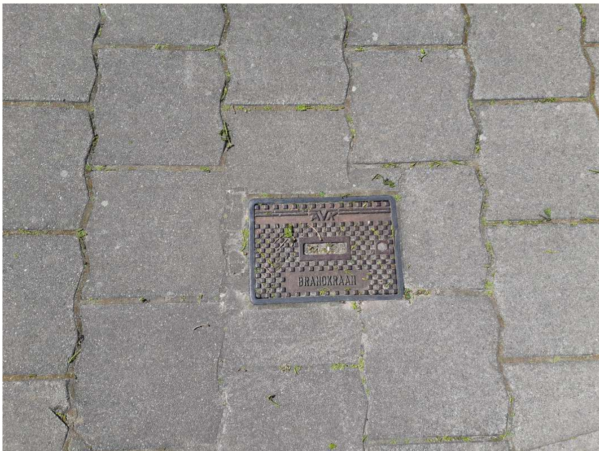
Figuur 11 Ondergrondse brandkraan/bluswaterafnamehydrant
