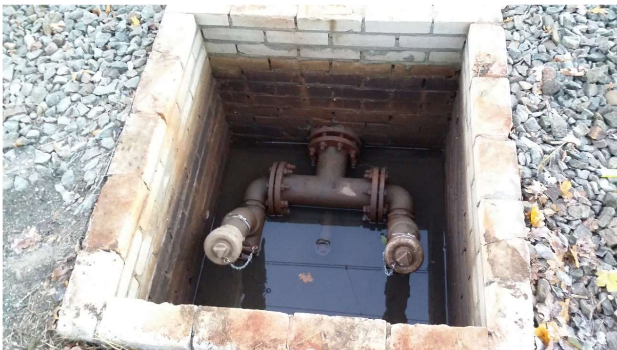
Figuur 20 Bluswatervulhydrant/ Ondergronds vulpunt drogeblus leiding
