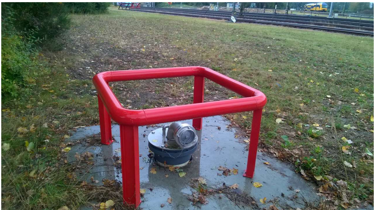
Figuur 8 Bluswatervoorziening: Geboorde put, gesloten met inhanger
