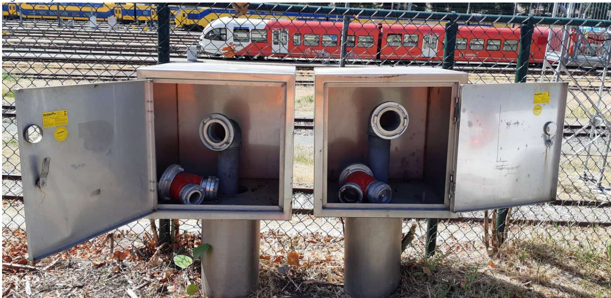
Figuur 4 Vulpunt droge blusleiding/bluswatervulhydrant
