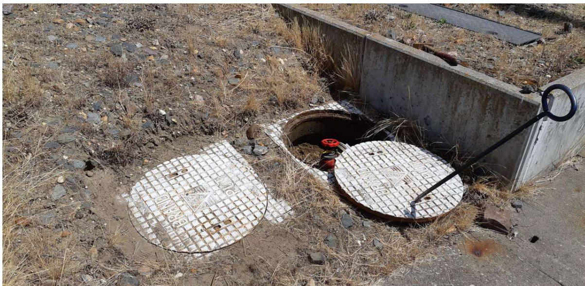
Figuur 12 Ondergrondse brandkraan/bluswaterafnamehydrant
