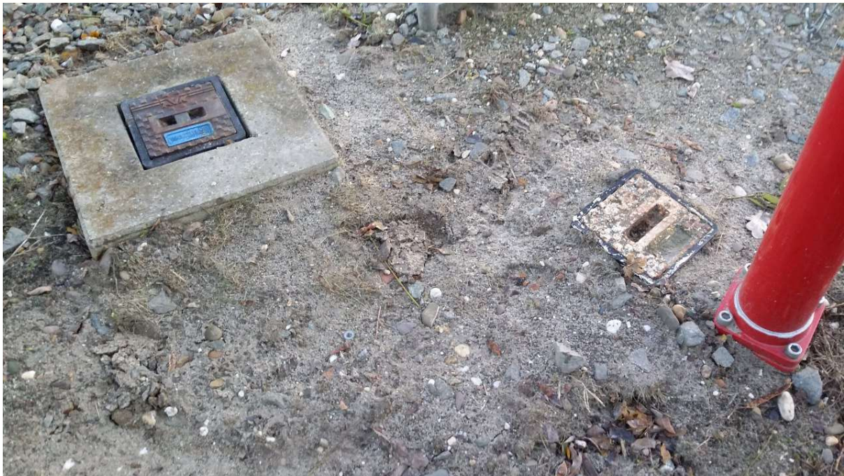
Figuur 1 Afsluiters, voor zowel riolerings-, water- en brandblusinstallaties kennen deze verschijningsvorm
