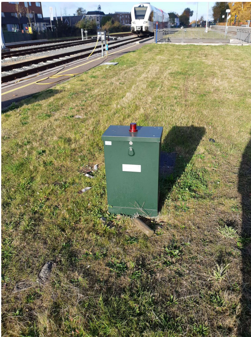
Figuur 14 Schakelkast persriool
