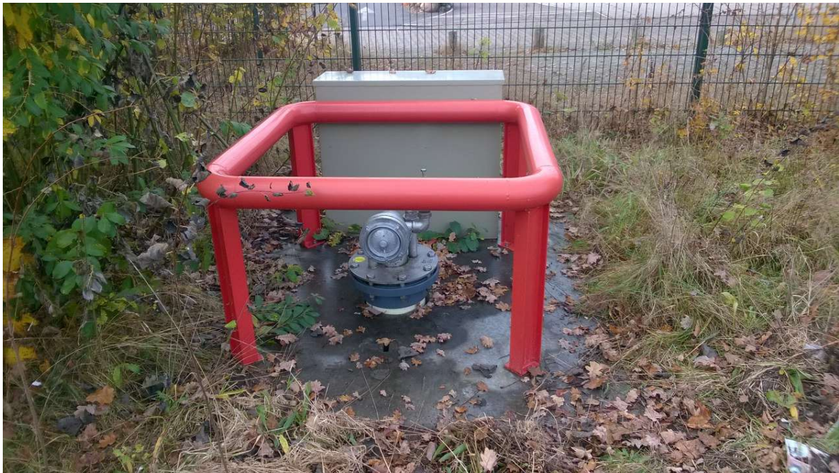
Figuur 9 Bluswatervoorziening: Geboorde put met bronpomp
