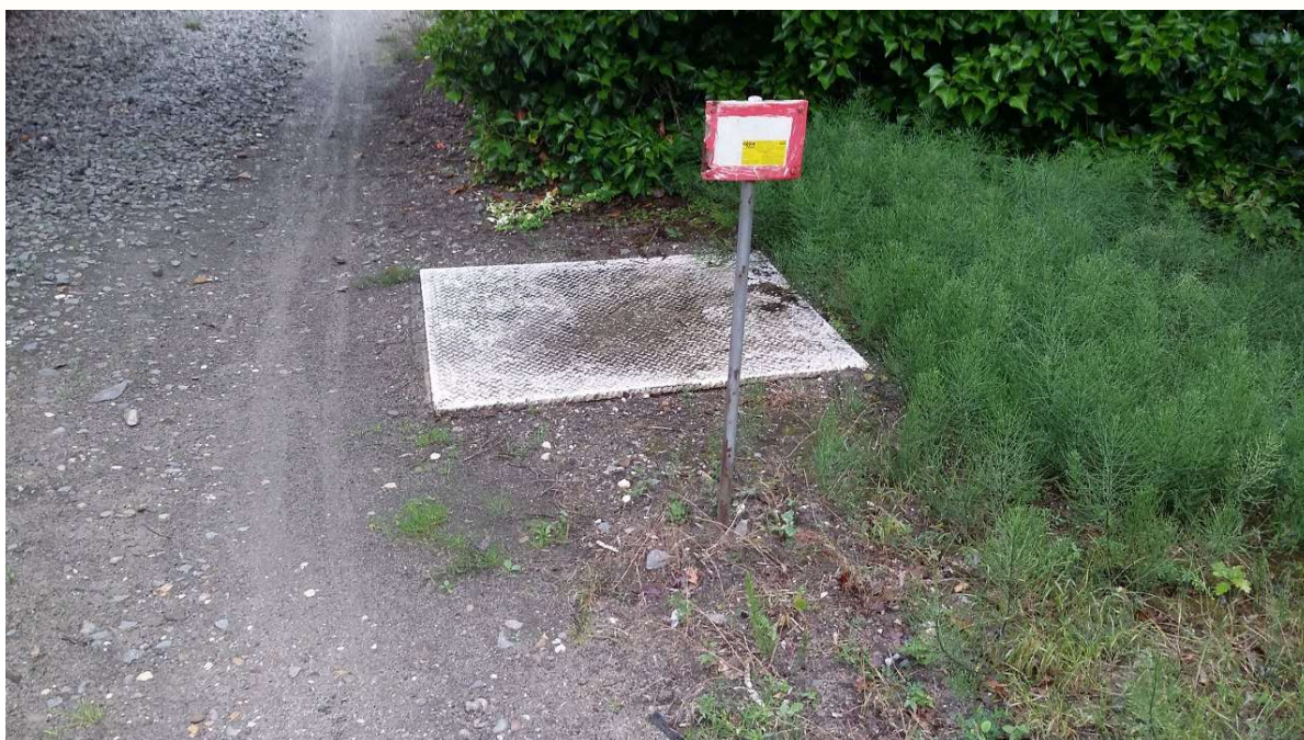
Figuur 21 Bluswaterhydrant Ondergrondse vulpunt droge blusleiding
