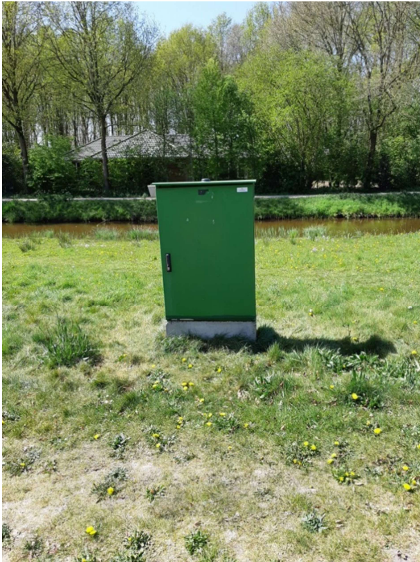
Figuur 15 Schakelkast persriool
