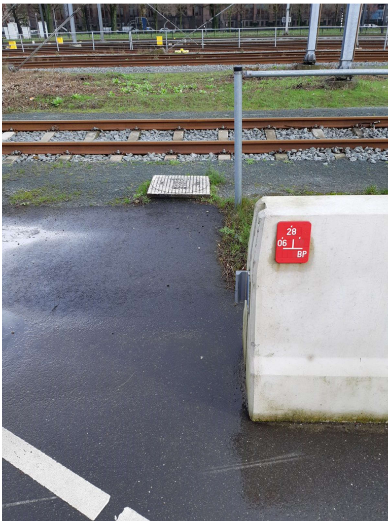
Figuur 10 Bluswatervoorziening: Geboorde put, open
