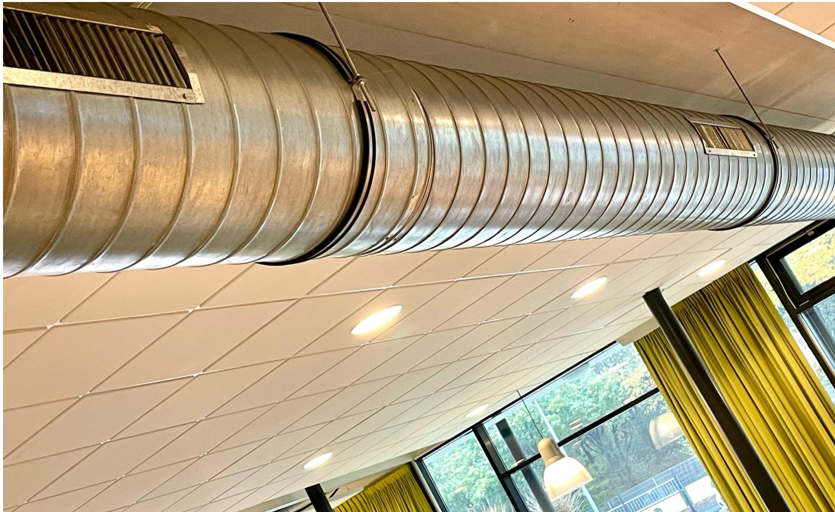
Foto van de ronde pijpen van de luchtbehandeling behorende bij vraag 27.
