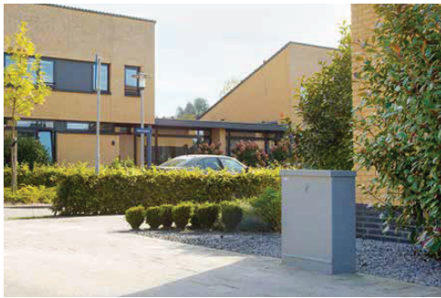
Een "zwervkast" voor data-techniek, een grote regelkast voor verkeerstunnelinstallaties
