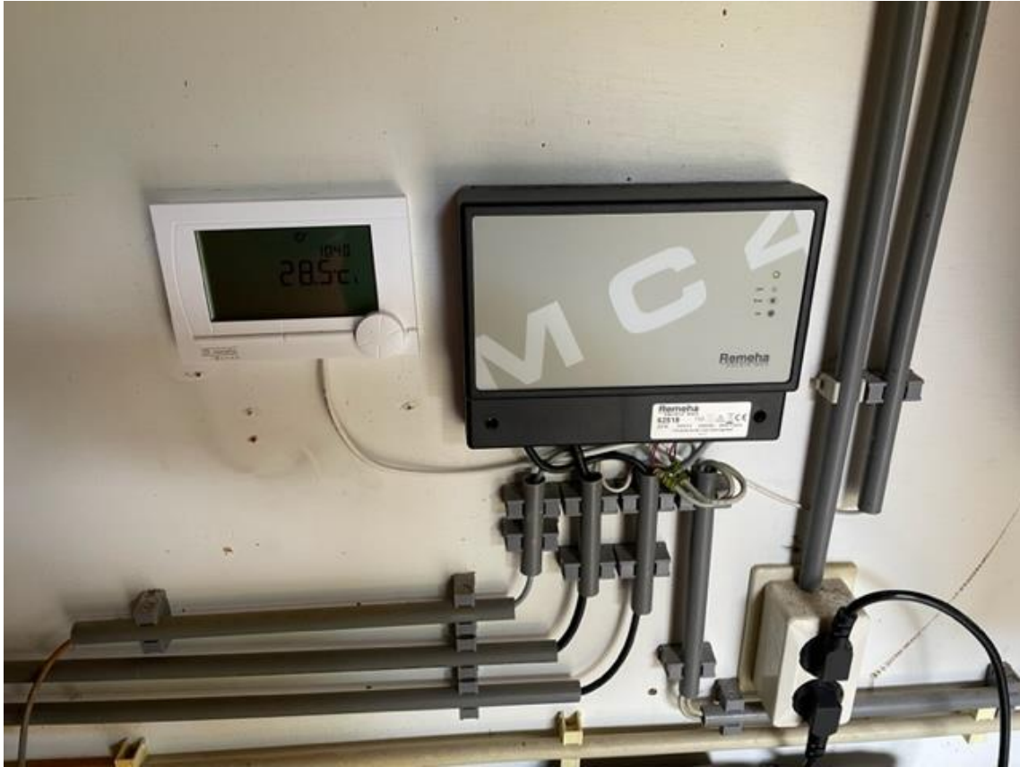
Thermosstaat in cv-ruimte. 28,5 graden??? Sturing/meting door kastje MC4
