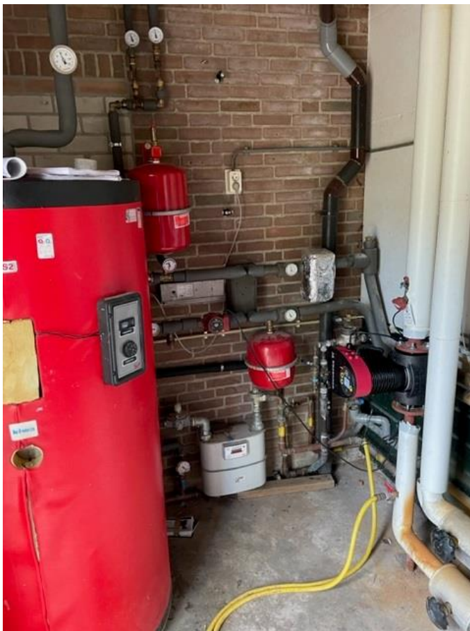
Overzicht boiler vat
