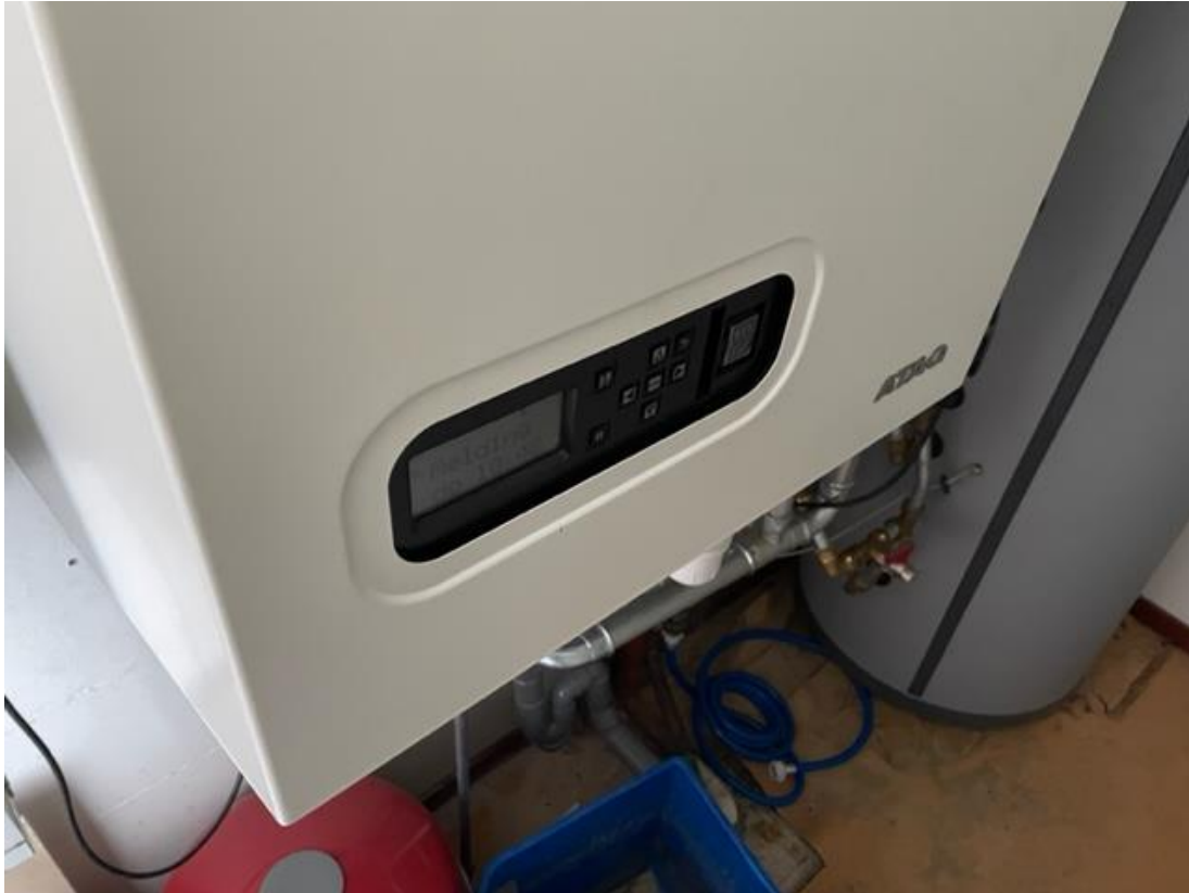
Nog een derde ketel bovenverdieping met boilervat.
