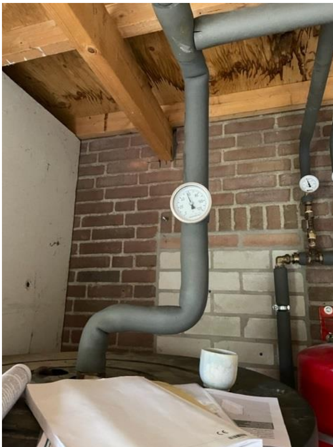
Niet alle leidingen zijn in voldoende mate geïsoleerd.
