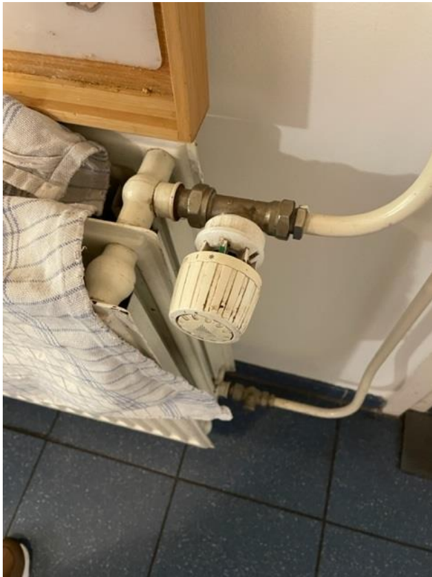
Radiatoren zijn voorzien van handbediende thermostaat knoppen.
