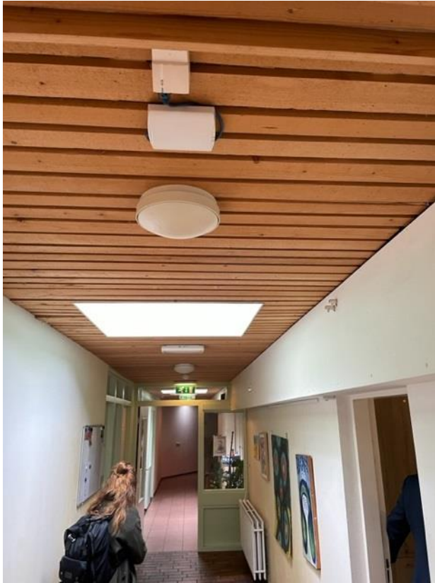
Lampunits met PL-lampen aanwezig (spaarlampen)
