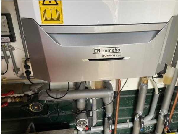
HR 107 ketels van Remeha.
