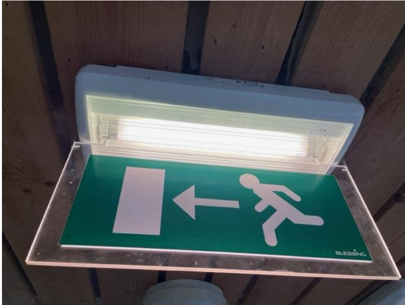
Vluchtverlichting ook nog in TL uitgevoerd
