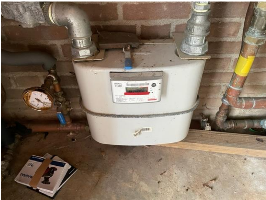
Geen slimme gasmeter aanwezig.
