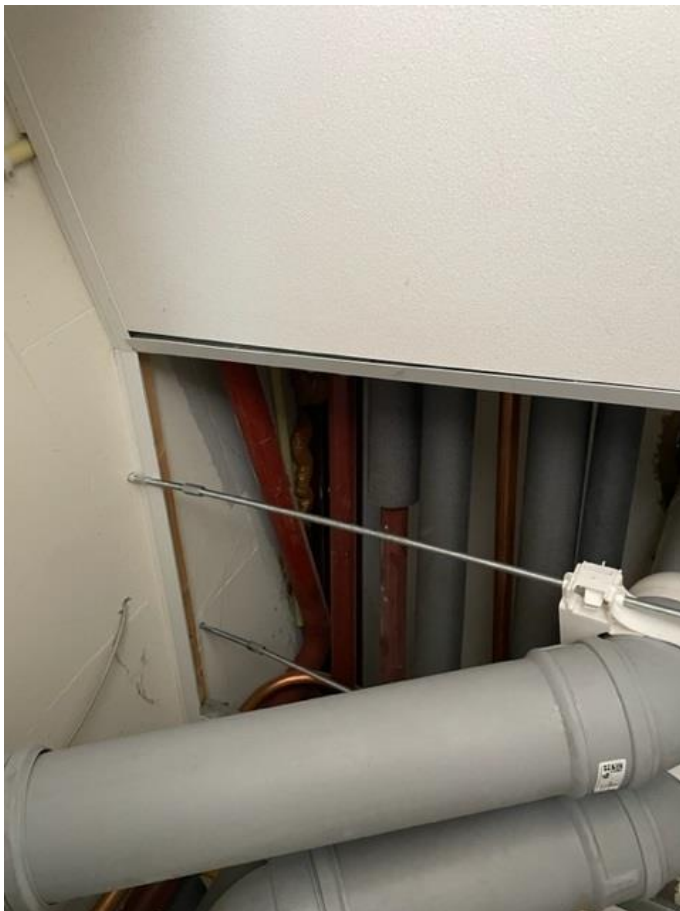
Leidingen niet voldoende geïsoleerd.
