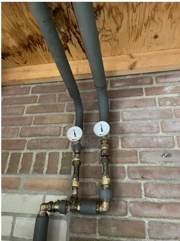
Hier ook niet voldoende de leidingen geïsoleerd
