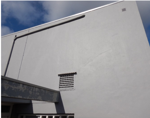
Figuur 6.23: Diverse reparaties zichtbaar
