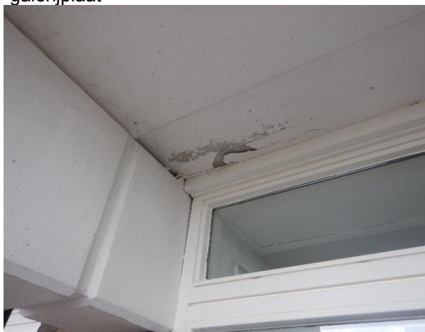
Figuur 6.6: Kleine betonschade aan de onderzijde van een galerijplaat
