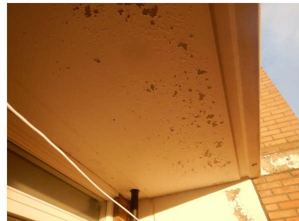
Figuur 6.4: Beschadigde coating onderzijde galerijplaat
