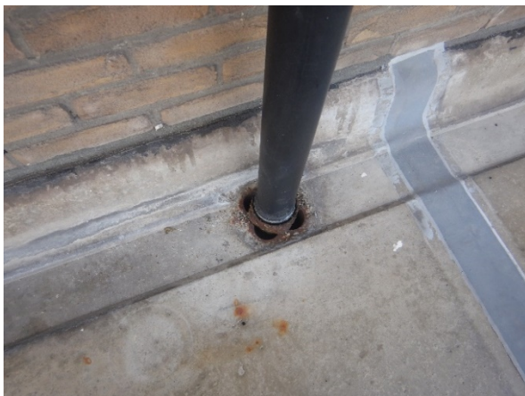
Figuur 6.3: Corroderende hemelwaterafvoer
