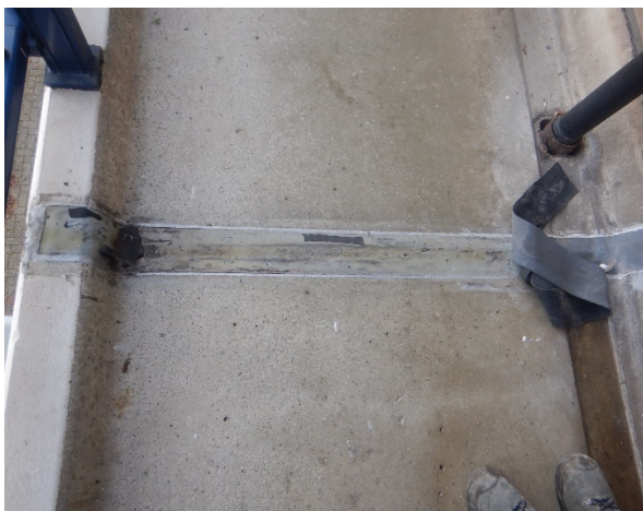
Figuur 6.5: Verouderde brugvoeg
