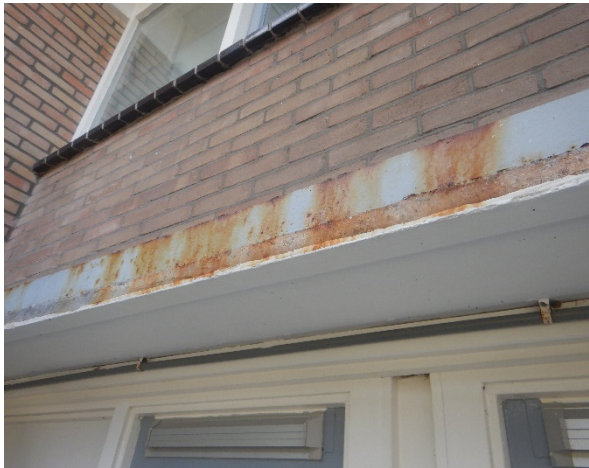
Figuur 6.7: Corrosie stalen profiel noodtrappen
