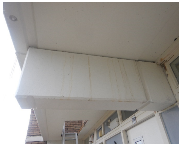
Figuur 6.15: Lekkagesporen langs console
