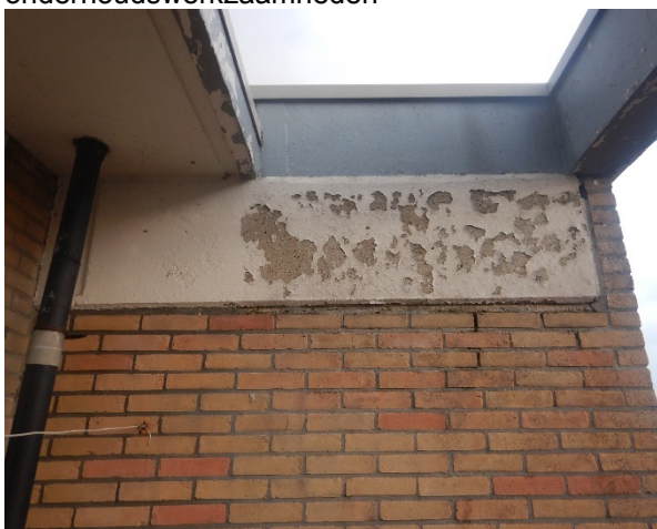
Figuur 6.16: Schade coating console dakvloer
