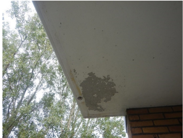
Figuur 6.19: Schade coating bovengelegen balkon
