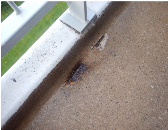
Figuur 6.20: Schade aan betondekking bovenzijde vloer
