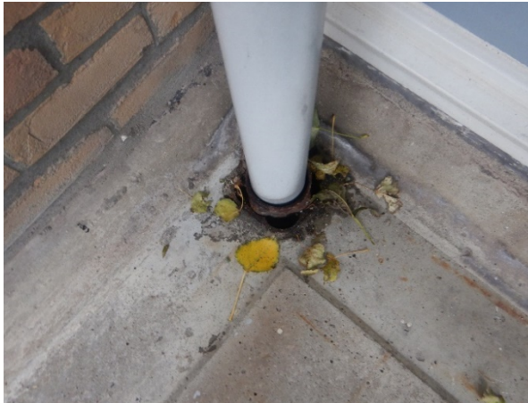
Figuur 6.18: Vervuilde hemelwaterafvoer
