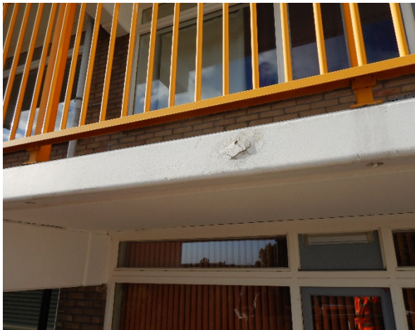
Figuur 6.9: betonschade zichtbaar diktekant
