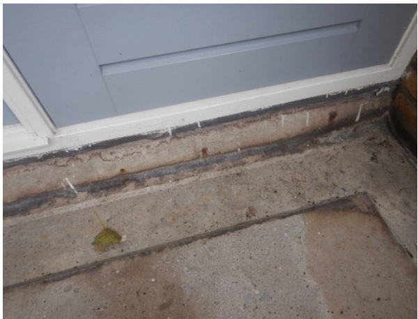
Figuur 6.21: Corrosieplekken opstaande rand
