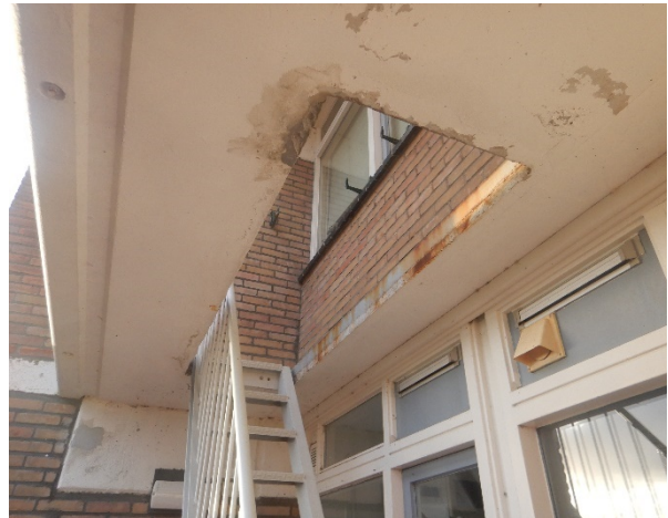
Figuur 6.8: Beschadigde coating rondom noodtrap
