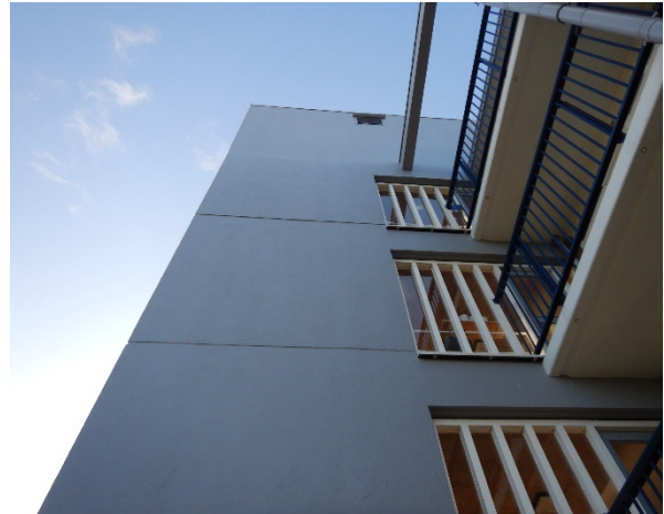
Figuur 6.24: Diverse reparaties zichtbaar
