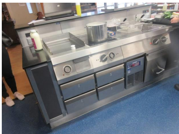
Keuken met elektrisch en/of gasgestookte fornuizen
