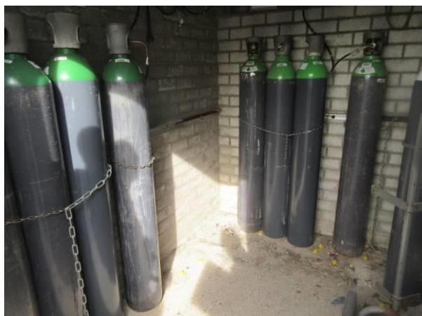
Gasflessenopslag (tussen bouwdeel C en E)
