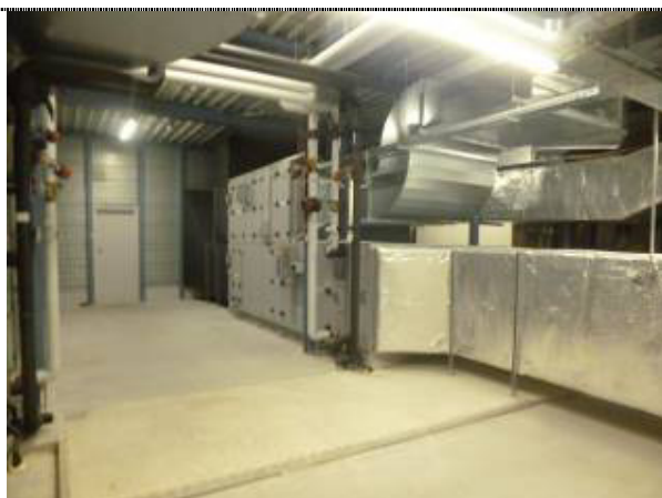
Foto 12: technische ruimte schoolgebouw
