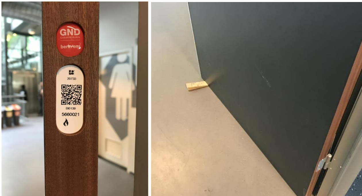
Keg onder brandwerende deur
