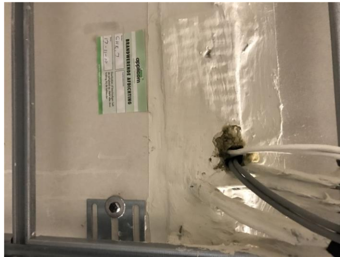
Niet brandwerend herstelde doorvoer in brandcompartment
