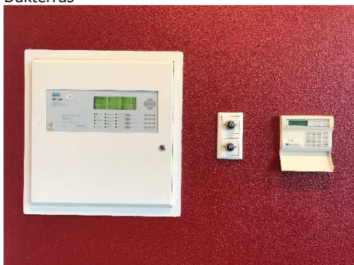
Brandmeld en inbraakcentrale
