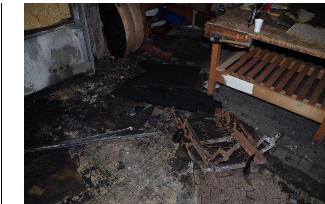
Foto 4: opname van de restanten van de fauteuil/zitbank die zich in de nis had bevonden en tot ontbranding was gekomen. De restanten zijn tijdens het onderzoek aangetroffen binnen het gebouw, direct achter de voornoemde overheaddeur en waren door de brandweer en de politie op die plek gedeponneerd.
