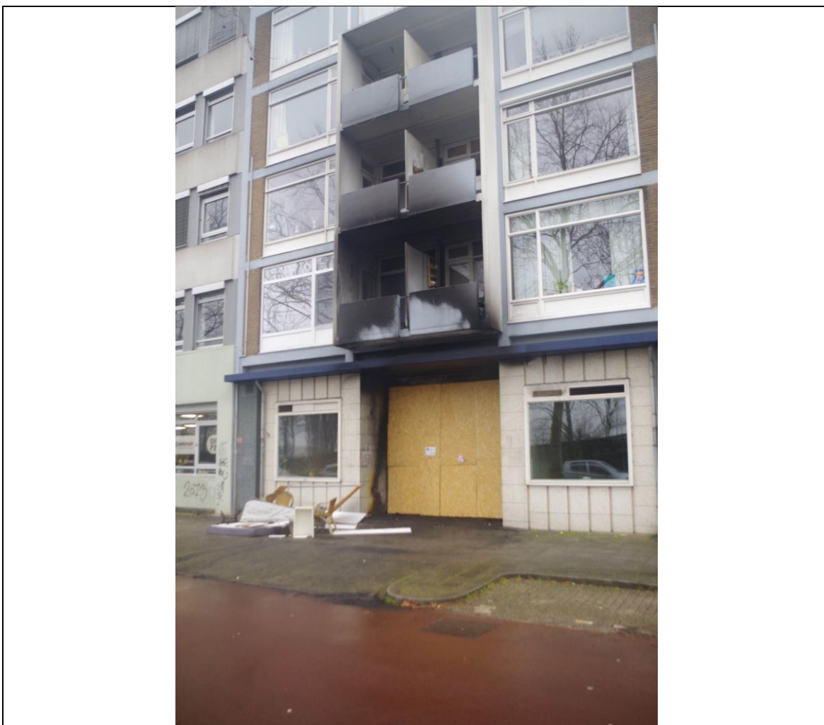
Foto 1: opname van de nis aan de buitenzijde en op de begane grond van het gebouw, waarin de brand was ontstaan en had gewoed.
