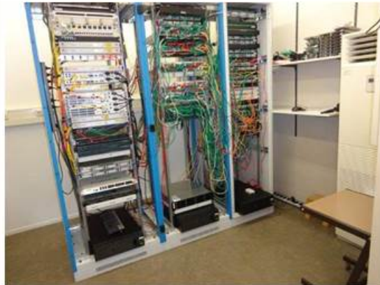
Foto 2 Centrale serverruimte voor alle locaties Arnhem
