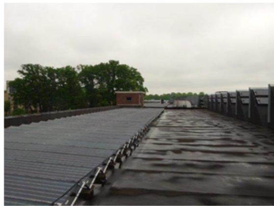
Foto 20 Zonnepanelen op het dak
