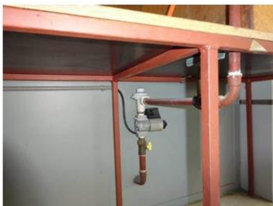
Foto 5 Gasmagneetklep op brander
