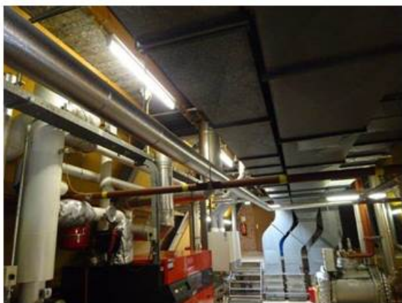
Foto 11 Technische ruimte zolder
