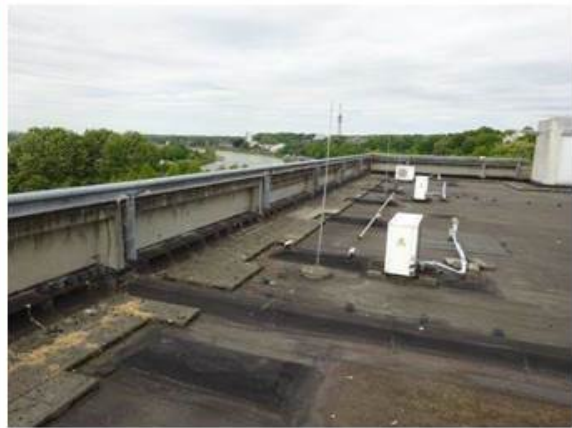
Foto 2 Airco units en bliksemafleider op het dak
