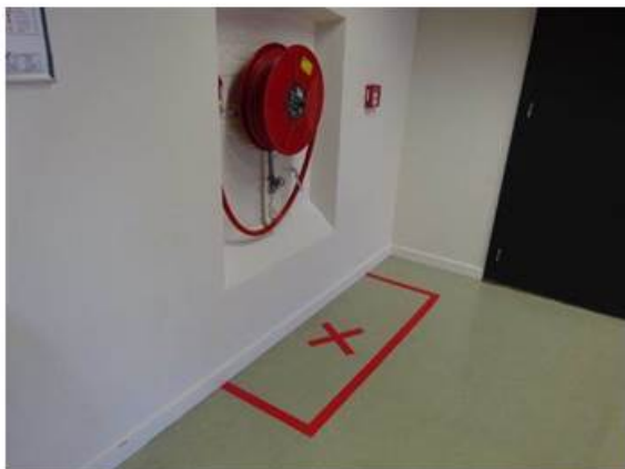
Foto 9 Brandslanghaspel met aanduiding voor vrijhouden vloer van opslag
