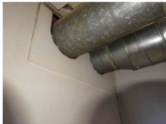
Foto 2 Onbeschermde doorvoer potentieel brandwerende scheiding
