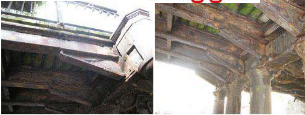
Afb. 4. (2 foto's) Enkele jaren geleden zag de brug er zo uit; belangrijker was de onveiligheid die in 2010 tot afkeuren leidde
