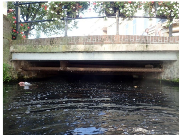
Foto 32: Dekrand oostzijde van het deel ouder dan 1926 waarvan de twee buitenste liggers onder het oorspronkelijke dek recent zijn vervangen; door twee IPE 200 profielen.
