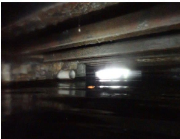
Foto 33: Onderzijde dek van het deel ouder dan 1926.
