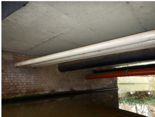
Foto 17: Onderzijde dek en landhoofd oost.
