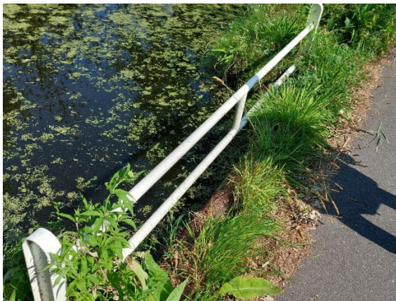
Foto 42: Noordelijke dekrand/leuning. Mantelbuis ligt naast het dek.
