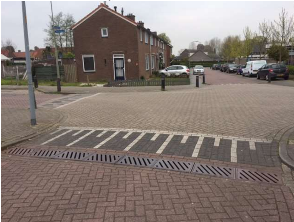
Voorbeeld “gekoppelde” kolken; reinigen per stuk, conform 110010 (Locatie: Eikstraat te Breedeweg)
