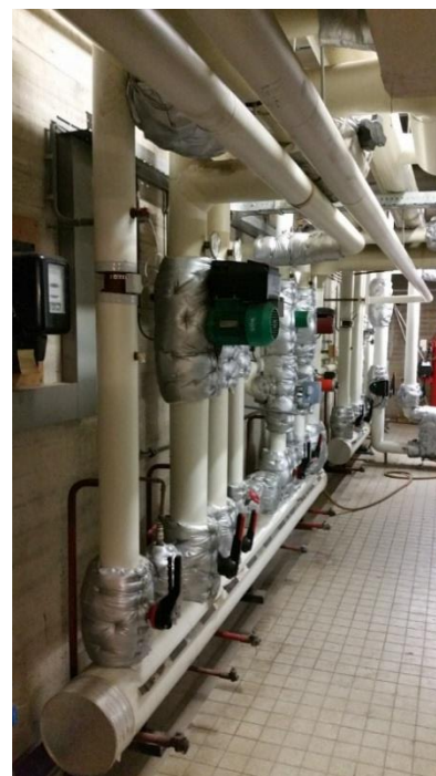
Figuur 7: Geïsoleerde CV-appendages
