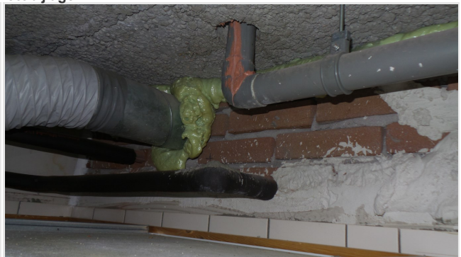
Afvoerleidingen en ventilatiekanalen.
