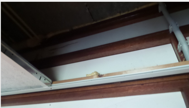
nobraanda plaat boven deurkozijn
