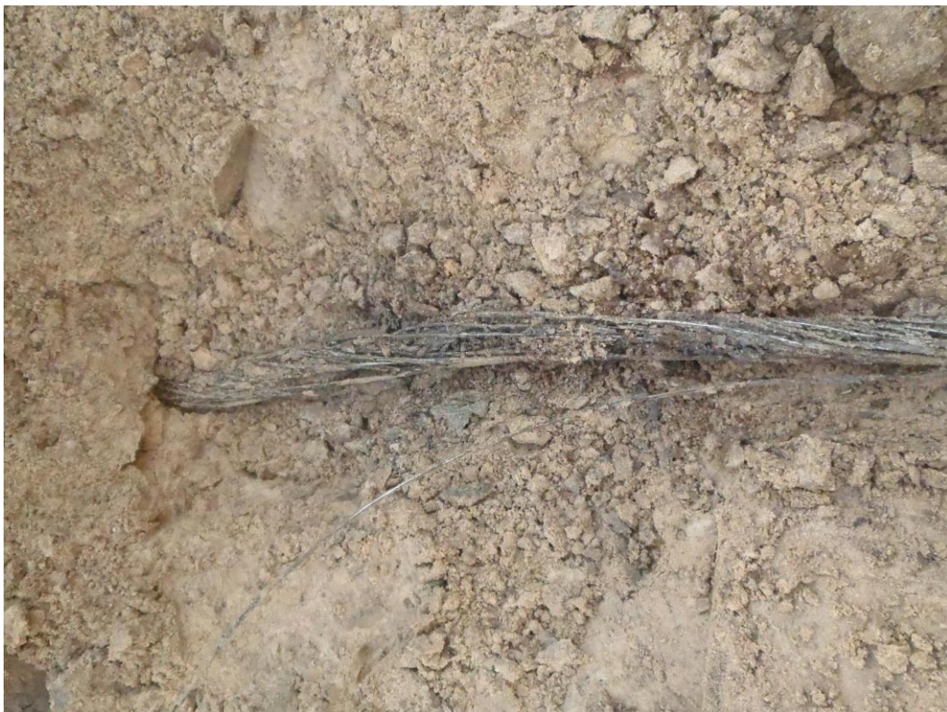
Locatie 9: oude kabel
