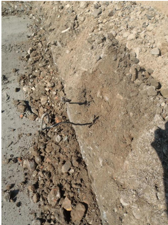
Locatie E3: Betonijzer in puinverharding
