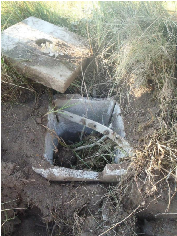
Locatie R15: aardpen in gewapend betonnen bak
