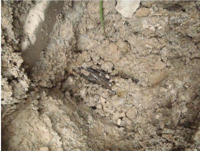
Locatie R3: Kabel (niet verwijderd)
