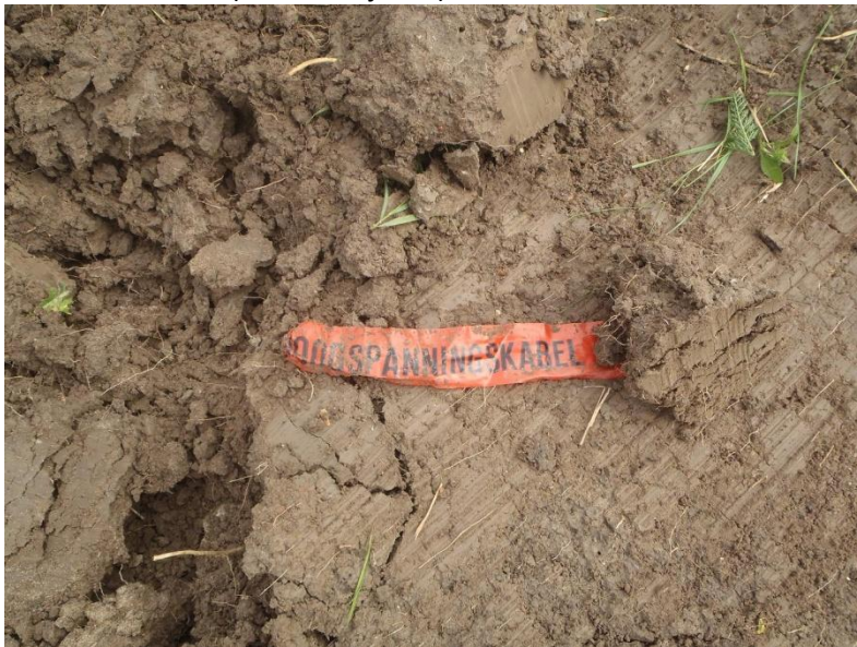
Locatie R4: HS kabel (niet verwijderd)
