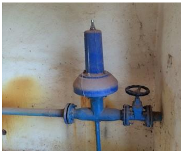
Une ventouse et la vanne d'arrêt
