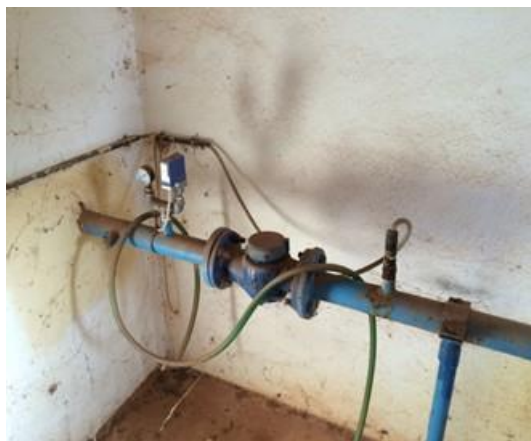
Manomètre, Pressostat et le compteur
