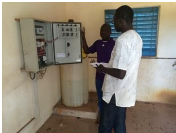
Armoire de commande électrique
