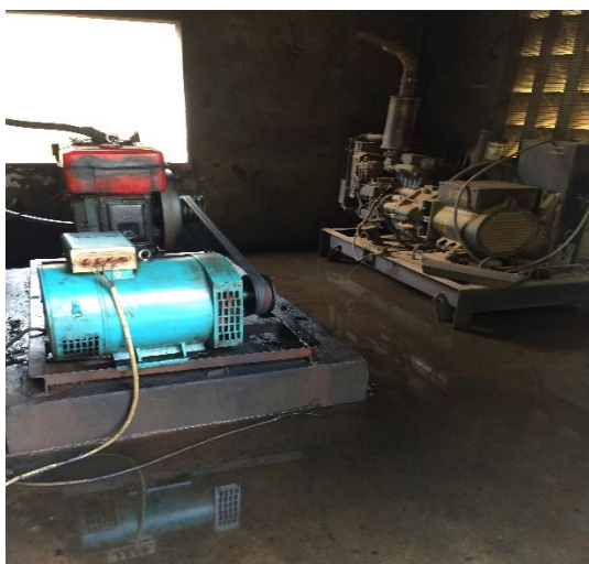
Groupe électrogène de l'ancienne station de pompage.
