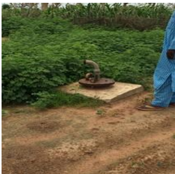
Tête du forage non équipée
