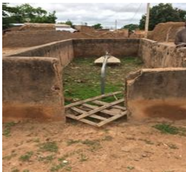
Tête du forage pour l'ancien réservoir
