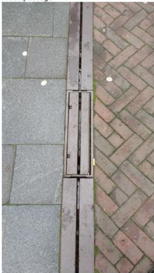
Lijngoot met doorspuitput na reinigen rand invetten
