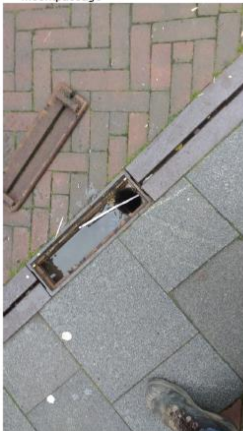
Lijngoot met doorspuitput na reinigen rand invetten
