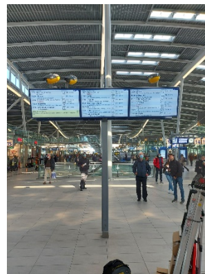
TB3 gemonteerd op een mast constructie
