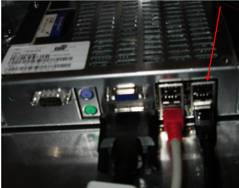
figuur 44 Aansluiting SBC netwerkkabels
