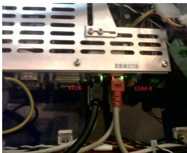
figuur 42 Aansluiting SBC netwerkkabels
