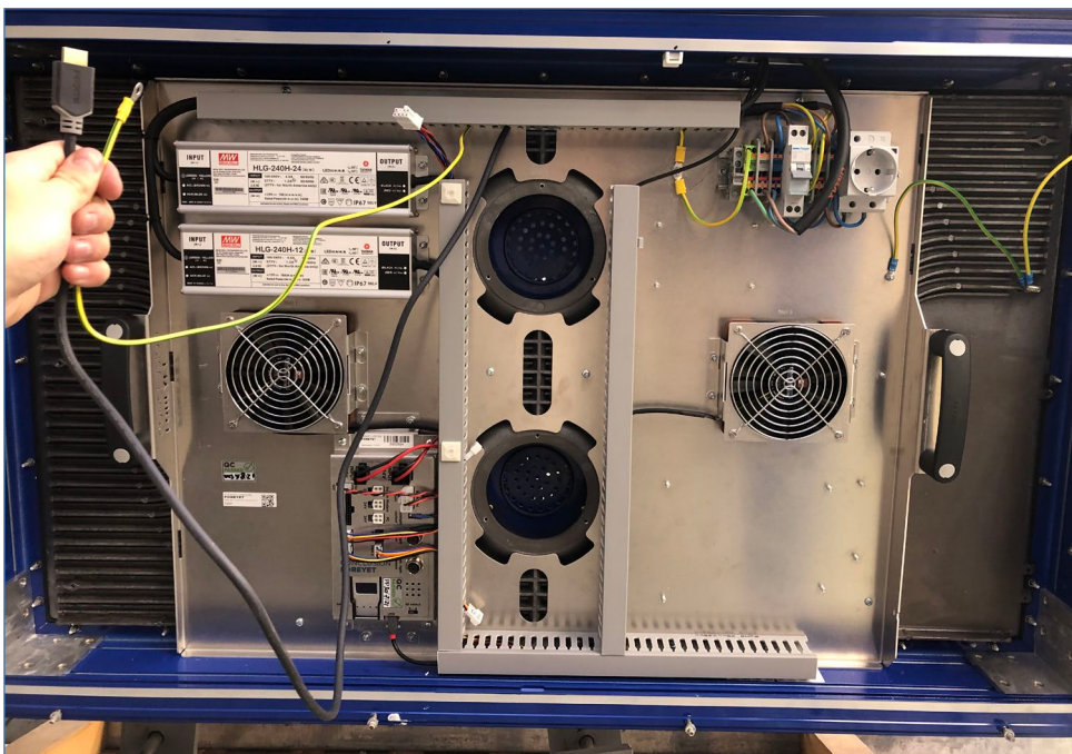
Figuur 6-11: Kabels aan Slave-zijde
