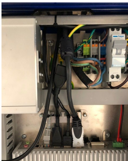
Figuur 6-12: Afwerking kabels rondom PC Master-zijde
