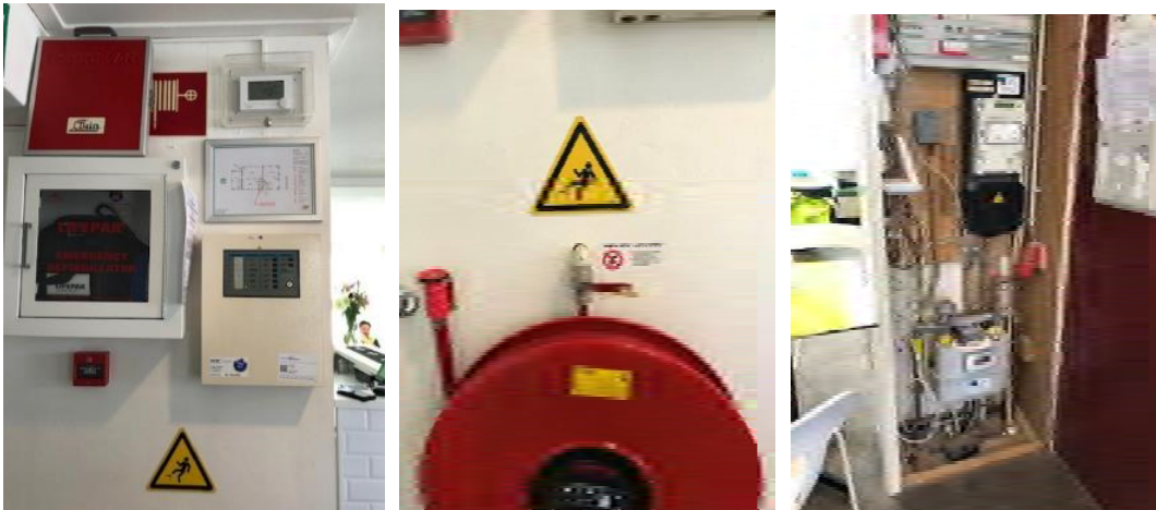
Brandmeldinstallatie, noodkit, slaghospel en de meterkast in het horecagebied
