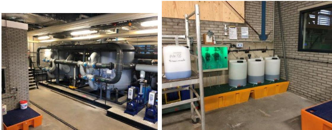
Kelder – orde en netheid pompkamer en opslag chemicaliën op opvangbakken
