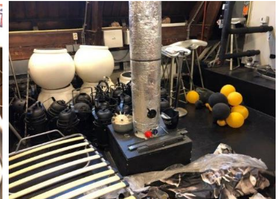
Opslag in technische ruimte
