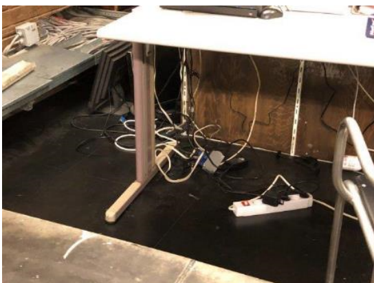
Gebruik van verlengsnoeren
