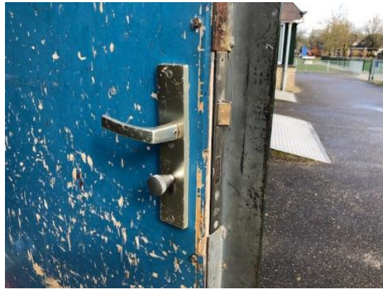
Sporen van inbraakpoging / vandalisme
