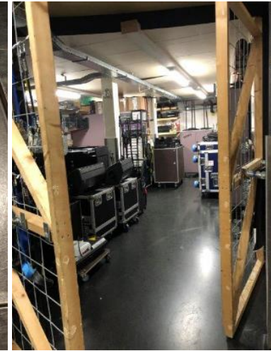
Opslag apparatuur in de kelder
