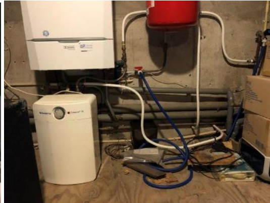
CV ketel en boiler op zolder
