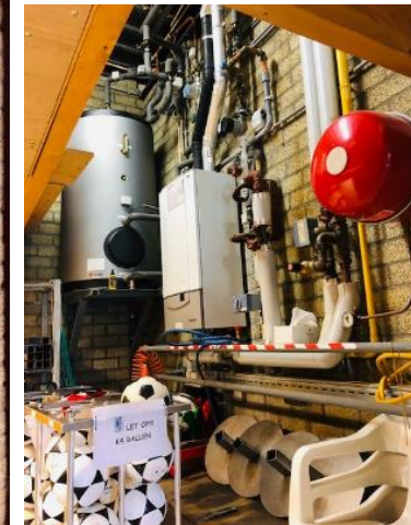
Opslag rondom ketel en boiler
