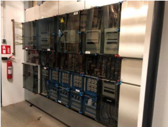
Omvormers zonnepanelen installatie
