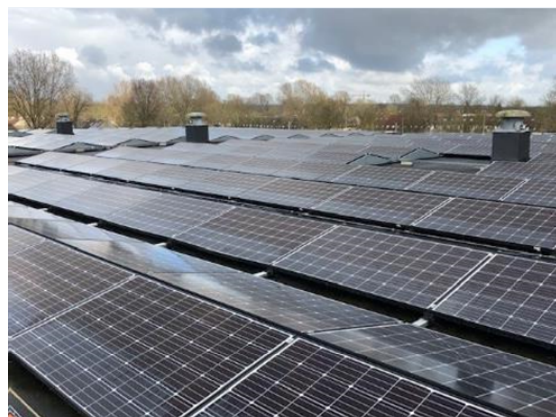
Zonnepanelen en bekabeling
