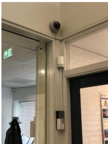
Dome camera en PIR sensor
