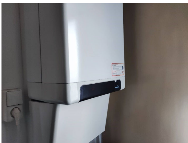
Afbeelding 2.1: Cv-ketels geplaatst in 2014
