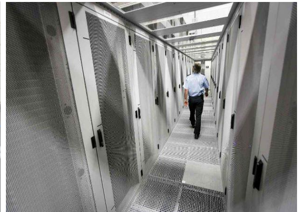
Een koude gang in ODC Belastingdienst
