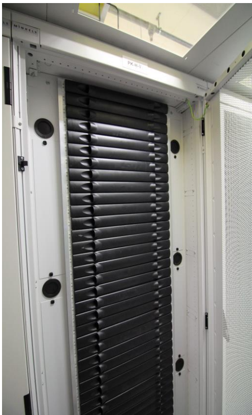
Blindpanelen ter voorkoming van luchtlekkage
