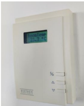
Bedienunits om verlichting aan te zetten.
